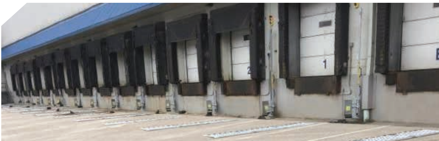
Les quais de chargement de l'usine SYSCO de Pittsburgh sécurisés par des dispositifs de retenue de véhicules POWERCHOCK.
