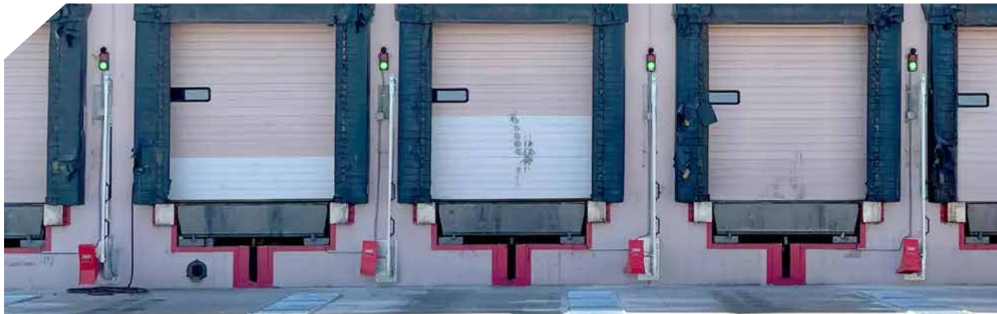
Installations de SGWS à Las Vegas – Installés en 2021.
