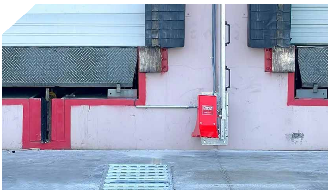
Installations de SGWS à Las Vegas – Installés en 2021.
