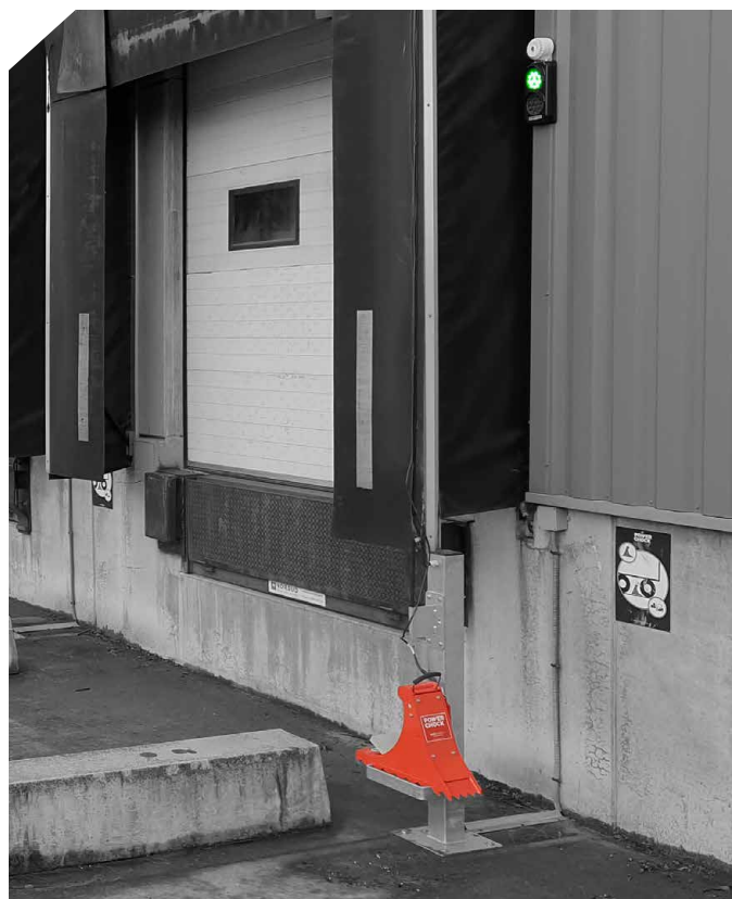
Les quais de chargement de l'entrepôt du Nord de la France sont équipés avec le modèle portable POWERCHOCK 3.
